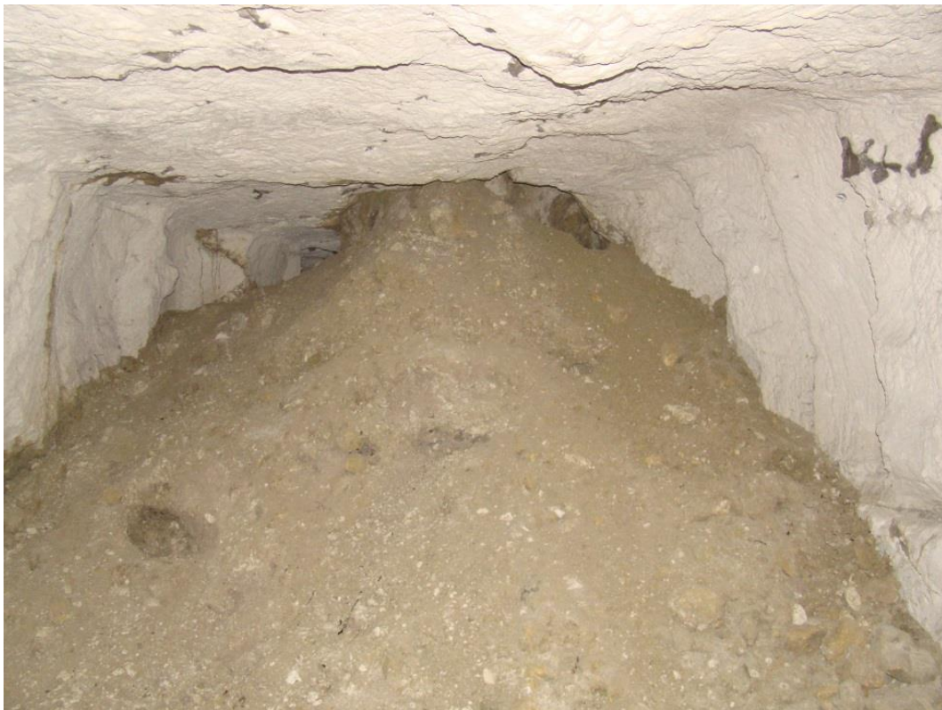
Illustration 8 : Cône d'éboulis lié à la remontée d'une cloche de fontis en surface, à l'origine d'un effondrement (toujours visible en surface)
